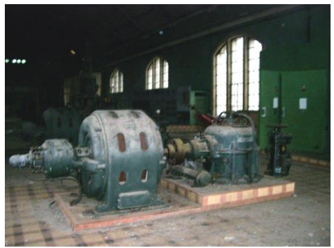
Les pompes installées en 1953
